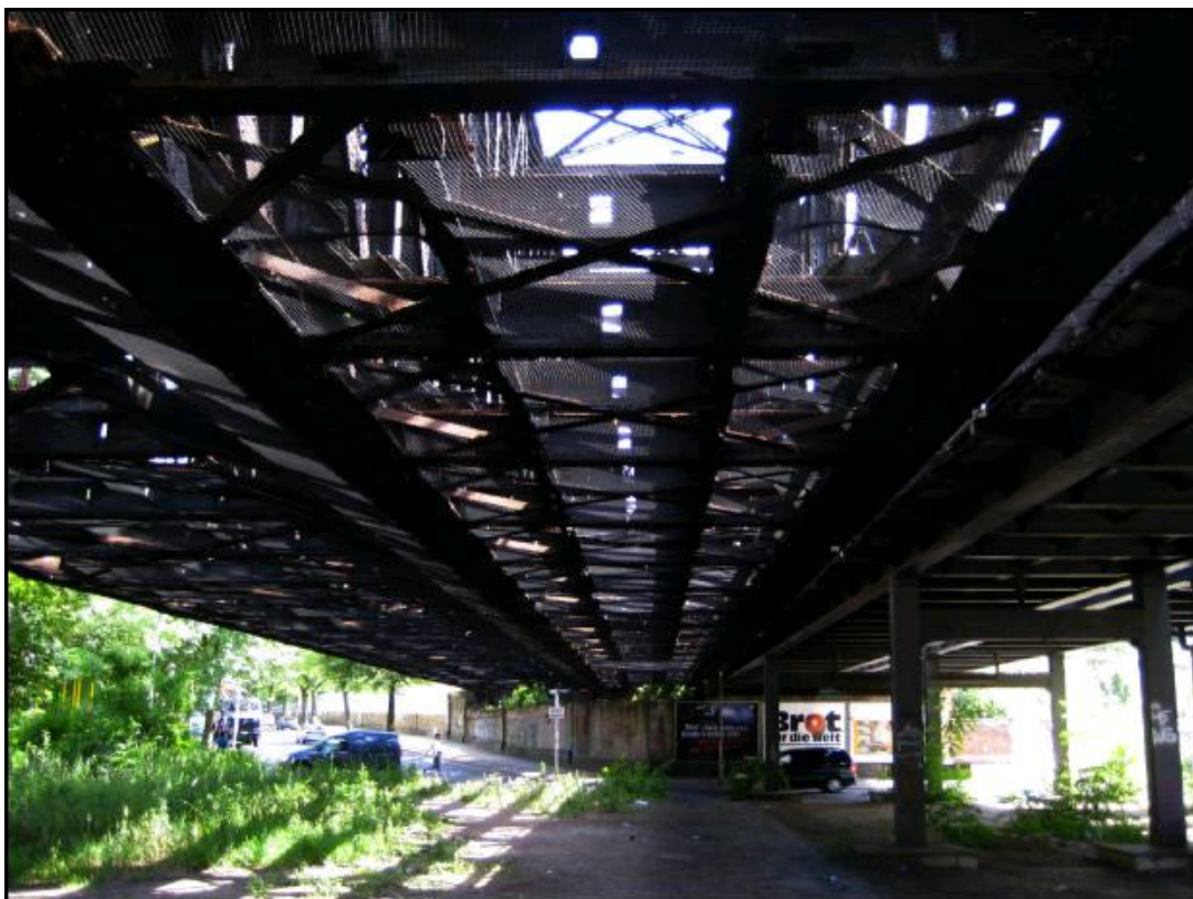
Foto 7: Liesenbrücke in Richtung Park am Nordbahnhof. Unter der Brücke sind Drahtgitter zum Schutz vor herab fallenden Rostteilen zu sehen. Quelle: Flanieren-in-Berlin.de (2006)
